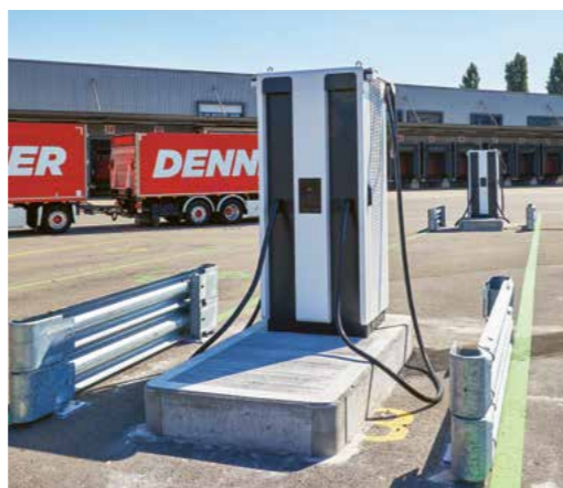
58 stations de recharge électrique sont mises gratuitement à la disposition du personnel Denner à différents endroits.
