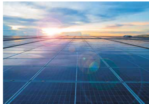
Chaque fois que cela est possible et judicieux, Denner a recours à des installations photovoltaïques.
